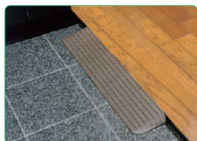
玄関(あがりかまち)の段差
